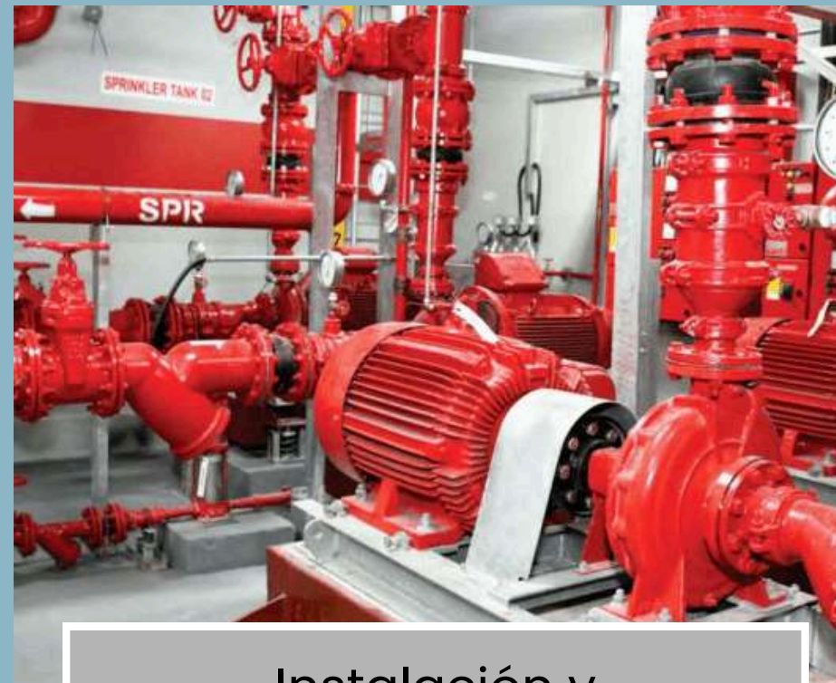
Instalación y mantenimiento de sistemas contra incendios
